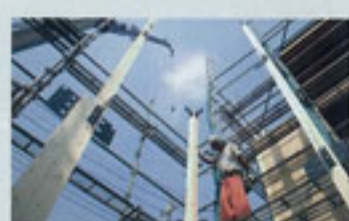
施工が進むSE構法のY氏邸。強度がはっきり分かる構造見学会が実施された
